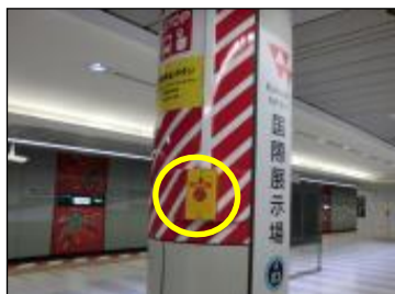
【非常停止ボタン】
