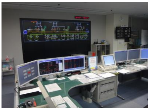
【電力管理システム】
