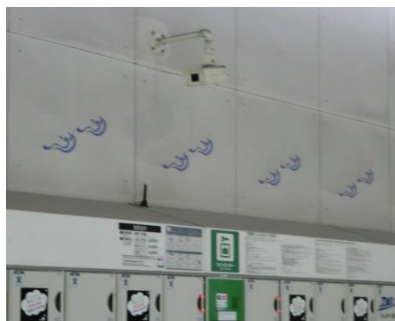
【防犯カメラによる監視】
