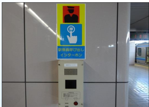
【駅係員呼び出しインターホン】
