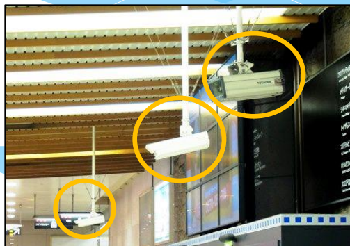
【防犯カメラによる監視】
