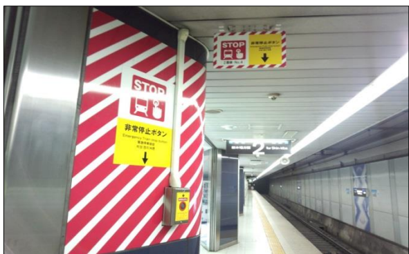
【非常停止ボタン】
