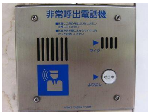
【非常呼出電話機】
