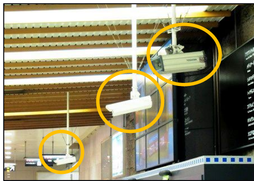
【防犯カメラによる監視】
