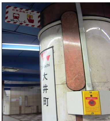
【増設した非常通報ボタン ※ 】
