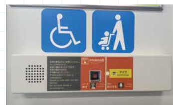
非常通話装置
