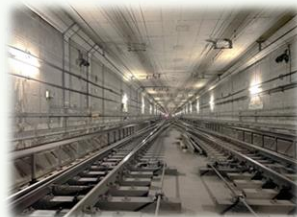
トンネル照明のLED化
