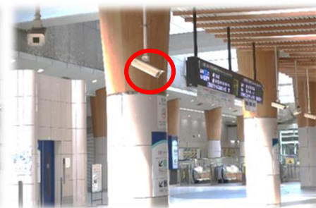
駅構内の防犯カメラ
