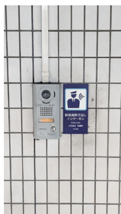
駅係員呼び出しインターホン
