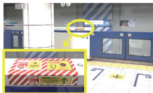
列車非常停止ボタン
