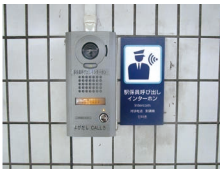
駅係員呼び出しインターホン
