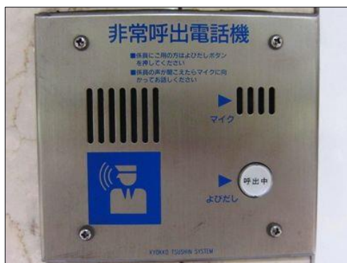
【非常呼出電話機】
